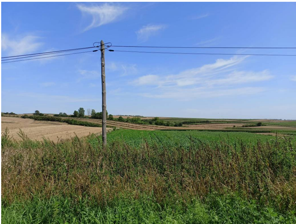
Fot. 3. Linia elektroenergetyczna w granicach obszaru opracowania
